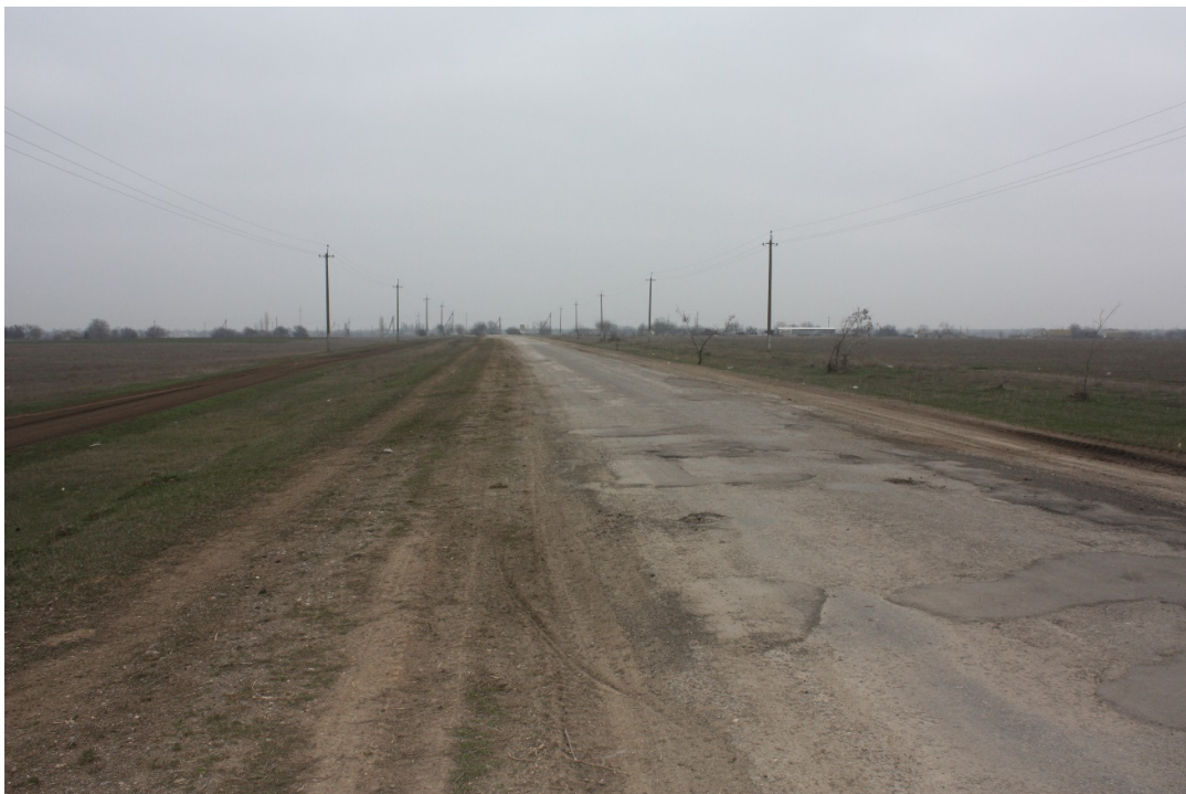
Рисунок 12-1. Стан дороги, яка веде до будівельного майданчика (T2206)
